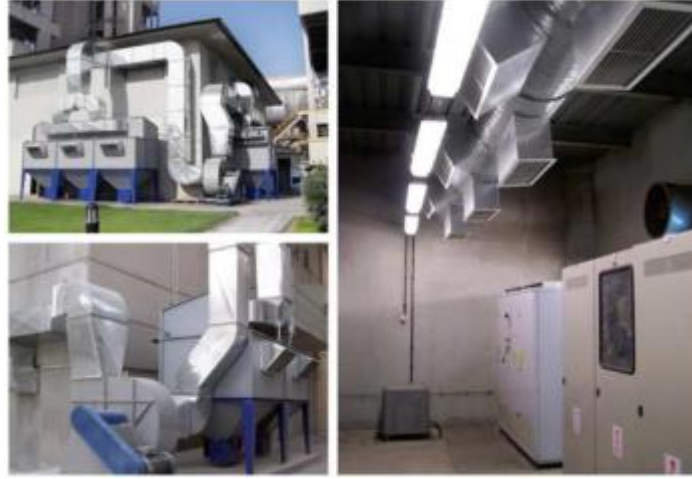
Şekil-14 Pano odası tozsuzlaştırma ve soğutma uygulamalarında, özellikle büyük güçteki elektrik motorlarının sürücü panolarının soğutulmasında yılın büyük bölümünde klimaya gerek kalmaksızın soğutma ve aynı zamanda tozsuzlaştırma yapabilen Patlaçlı Kartuş Filtre (Jet-Pulse) kullanılır.
