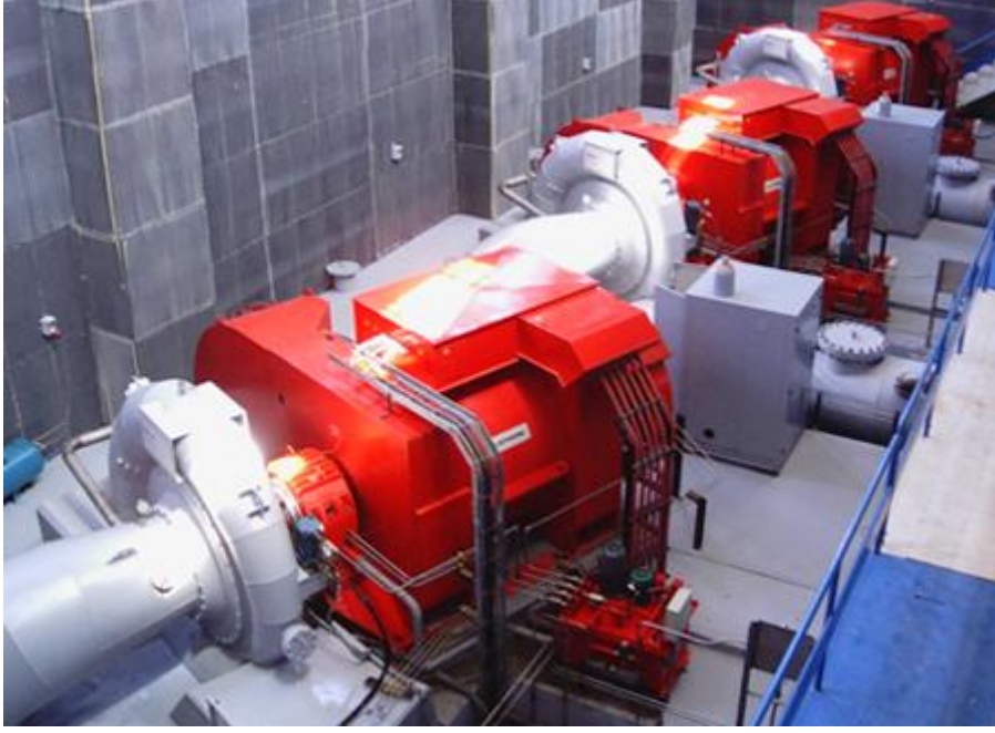
Şekil-4.7 Türbin-jeneratör grupları
